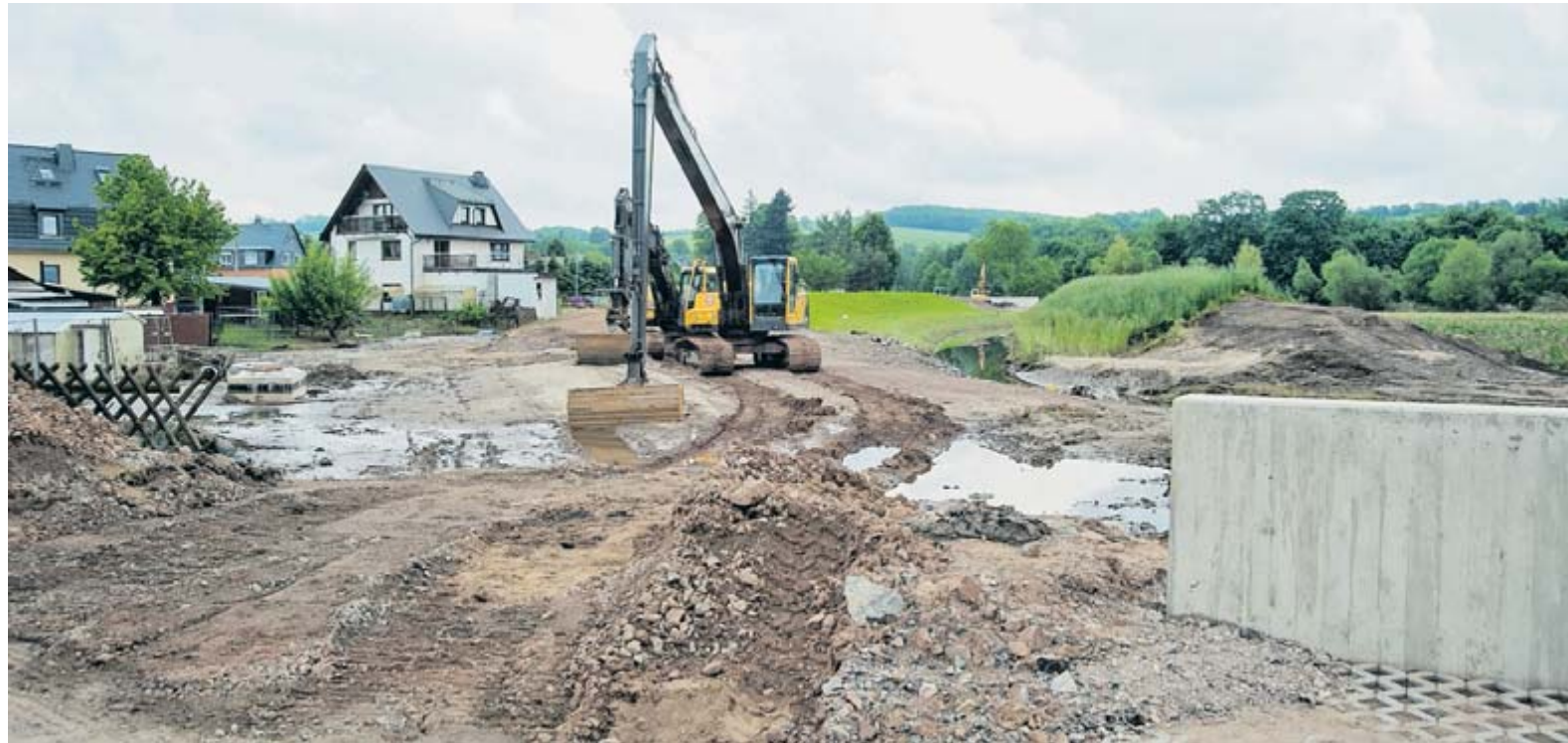
Weil der Hochwasserschutzdamm an der Landbrücke noch zwei Lücken hat, rechnet man in Niederwiesa mit Millionenschäden.
